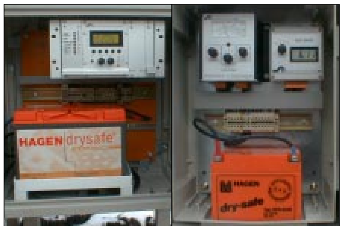
Bild 18 Schaltschrank System 1 und 2
