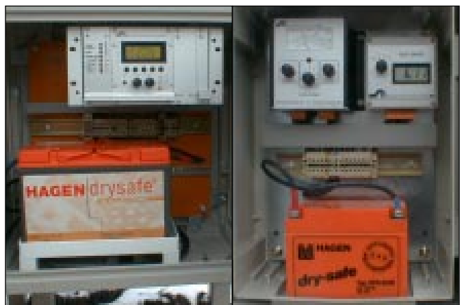
Bild 18 Schaltschrank System 1 und 2
