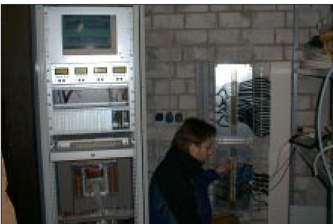
Bild 17: Schaltschrank mit Messdaten-Erfassung und Schutzstromgeräte 1 bis 4
