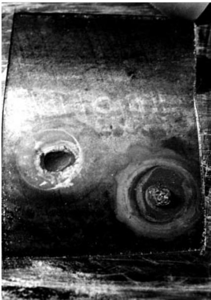
Abb. 7: Umhüllungsbeschädigung und Wechselstrom-Korrosionsschaden an einer kathodisch geschützten Polyethylenumhüllten Rohrleitung
